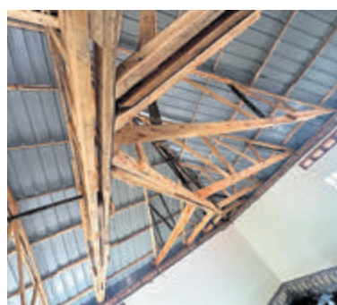
Het plafond van de kleuterschool moet worden hersteld.
