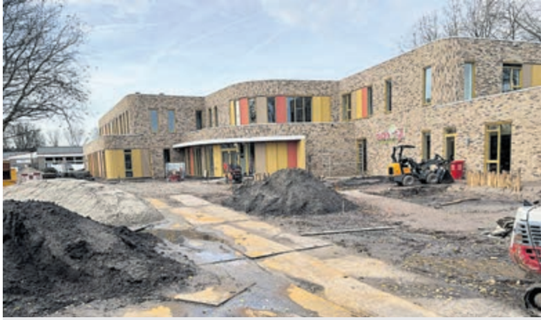
De bouw van de nieuwe scholen is al duidelijk zichtbaar. Eigen foto.
