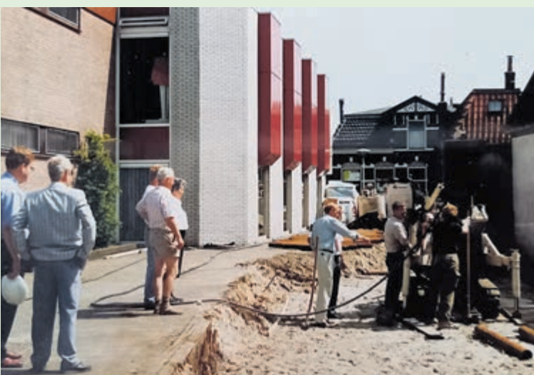
Het plaatsen van de eerste heipaal voor het nieuwe pand van Modehuis Van Yperen in de Dorpsstraat in Mijdrecht. Foto is aangeleverd.
